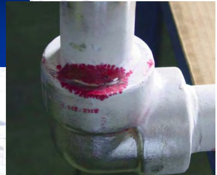
Detección grieta líquidos penetrantes
